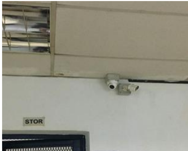
CCTV di ruangan dalam Balai Polis BBK
