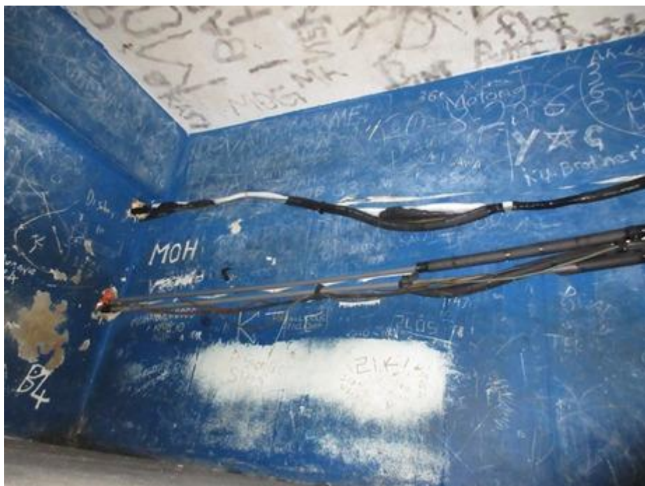
Kabel penghawa dingin di dalam Ruang Khas OKT
