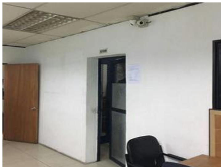
CCTV di ruangan dalam Balai Polis BBK
